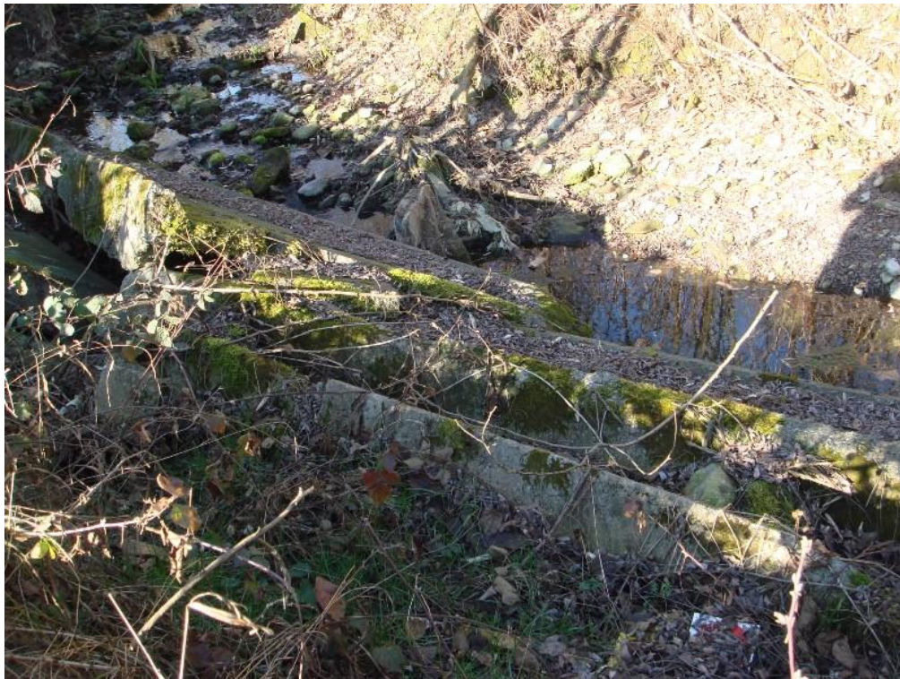
Figura 13.23 - R. Nava – pannelli in cls a protezione meandro esterno franati in alveo
