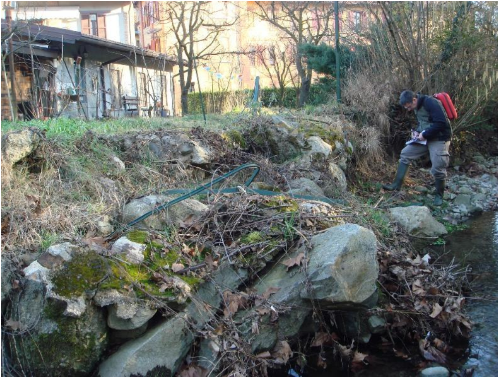
Figura 13.22 - T. Lavandaia – muri/scogliera di difesa spondale franate in alveo
