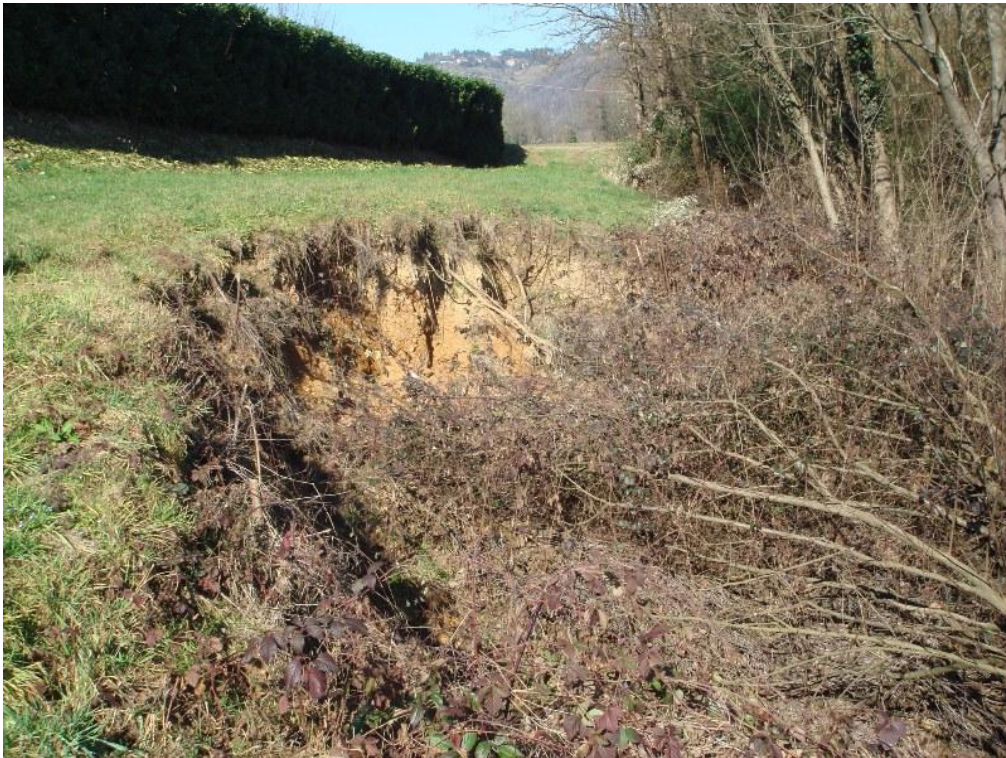
Figura 13.7 - Frana presso Cascina Brughiera – coronamento nicchia di distacco in fase di progressivo arretramento
