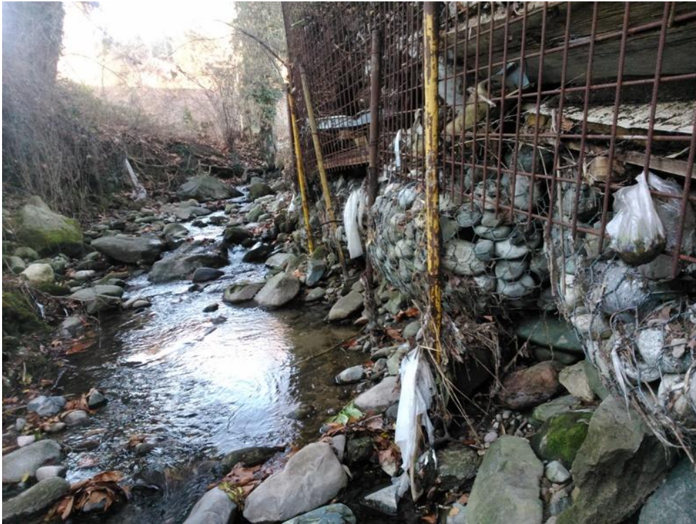
Figura 13.24 - T. Lavandaia – interventi di difesa spondale fittizi e di dubbia funzionalità idraulica
