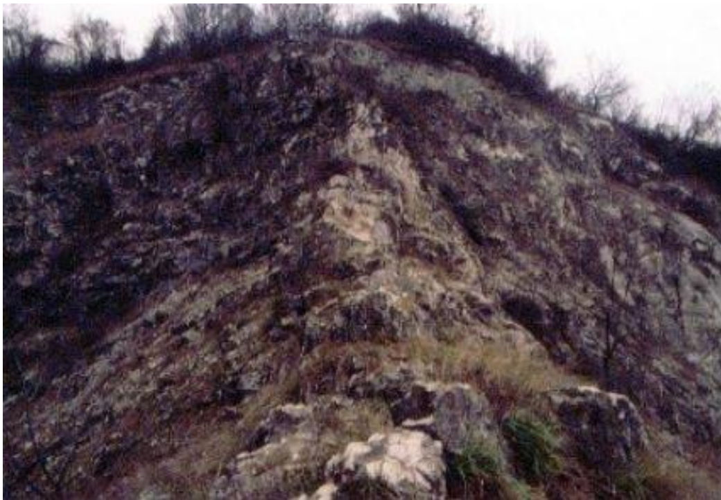
Figura 13.18 - Ex cava di pietra – pareti rocciose sub-verticali potenziale sorgente di crollo di blocchi singoli o in massa
