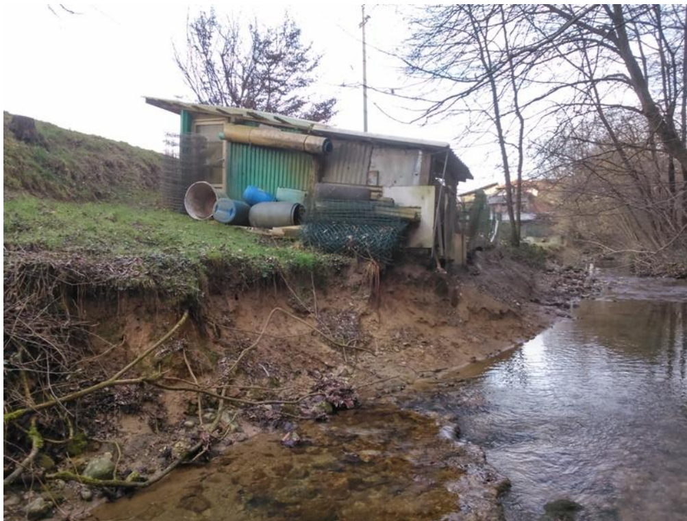
Figura 13.2 - T. Molgoretta - erosione spondale con arretramento/franamento del ciglio
