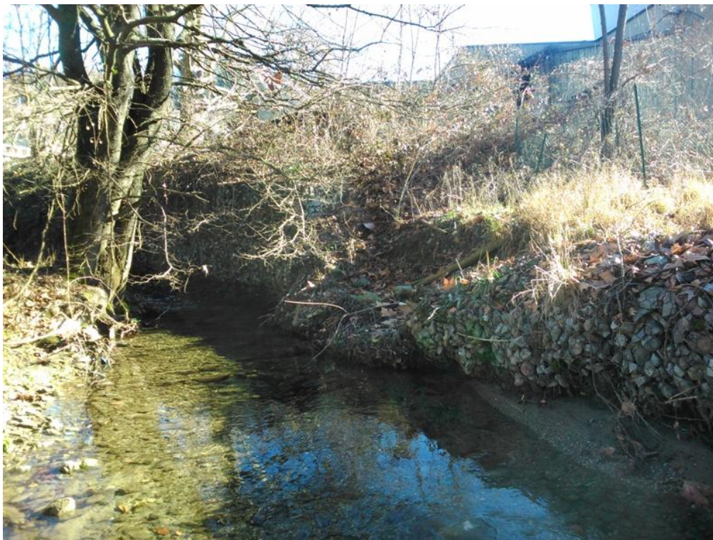
Figura 13.21 - T. Lavandaia – gabbionate ammalorate franate in alveo
