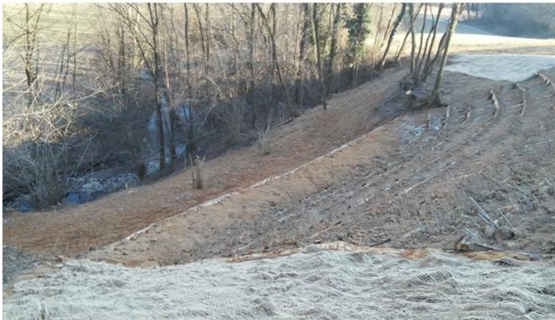
Figura 13.13 - Frana di Cascina Brughiera – cfr. didascalia Fig. 13.12
