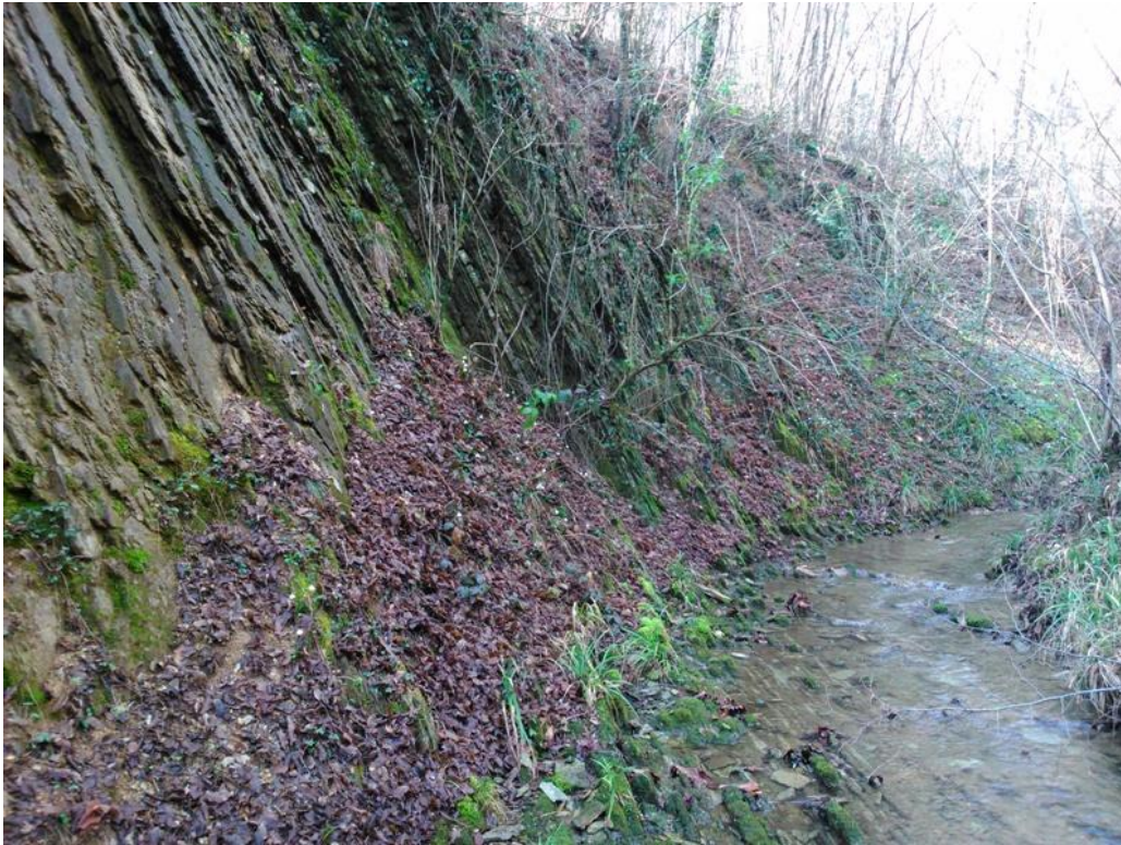
Figura 13.19 - T. Molgoretta – parete rocciosa in destra idrografica potenzialmente sorgente di crollo di blocchi di roccia
