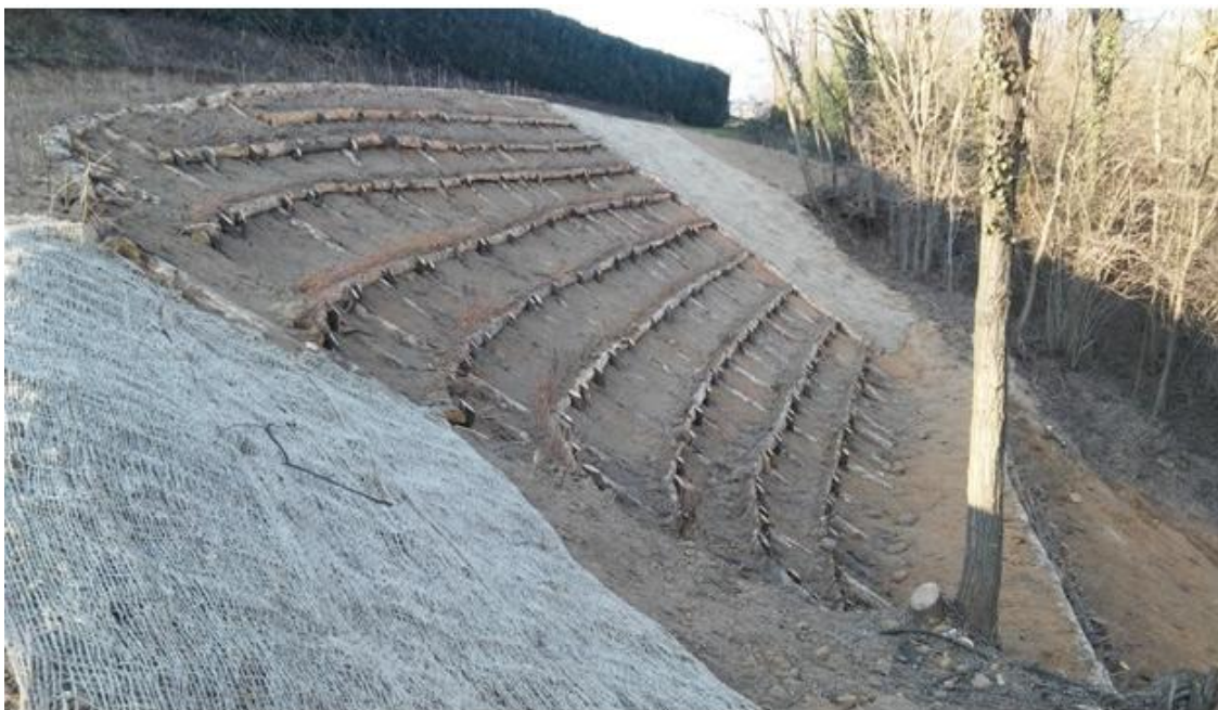
Figura 13.14 - Frana di Cascina Brughiera – opere di consolidamento coronamento e di stabilizzazione/protezione dall'erosione del terreno con geostuoie
