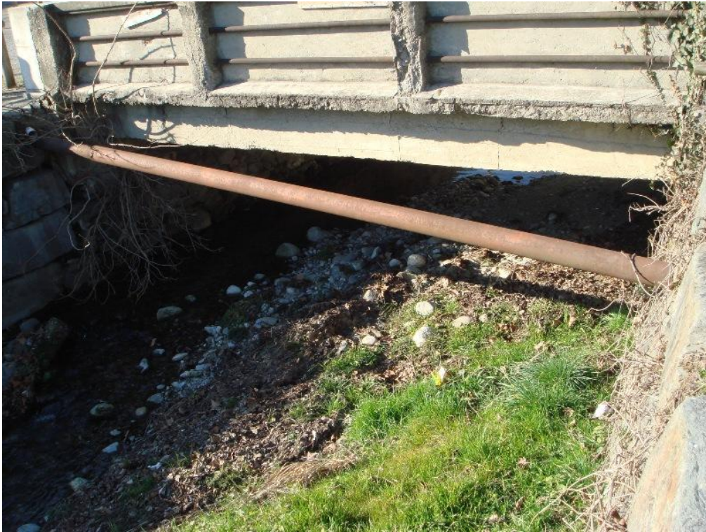
Figura 13.6 - T. Lavandaia – sovralluvionamento presso il ponte di via Merlini
