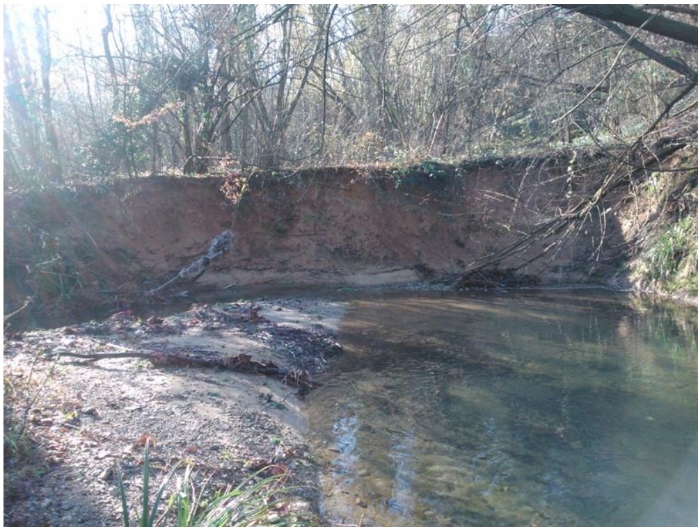
Figura 13.4 - T. Lavandaia - erosione spondale su meandro esterno
