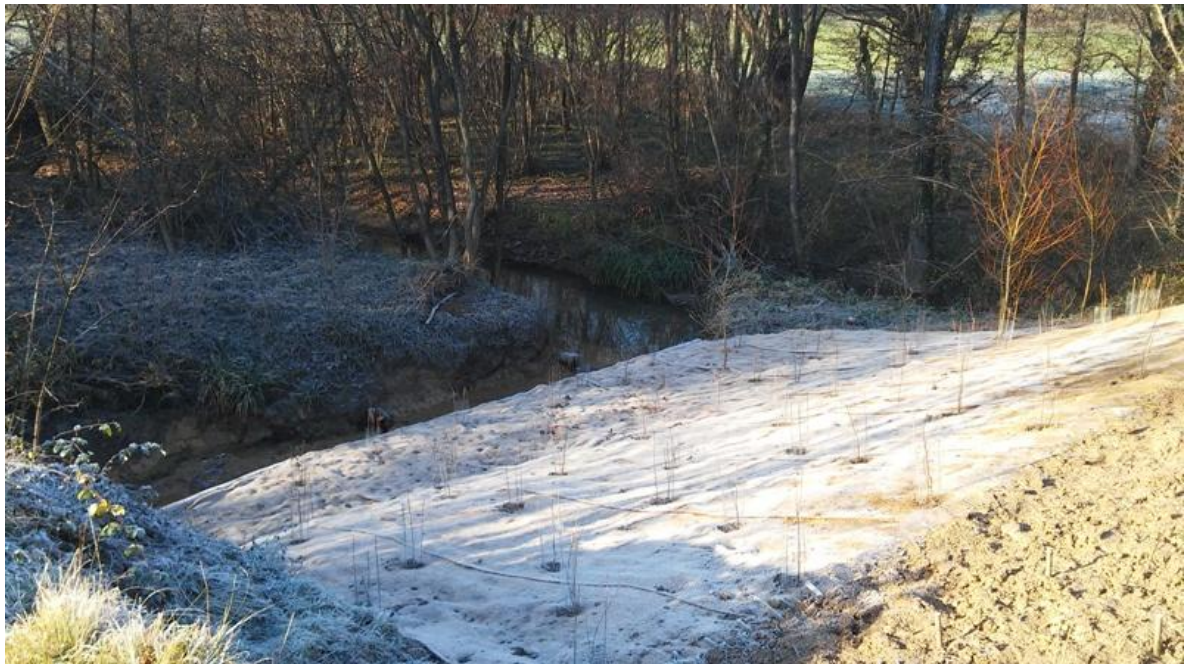
Figura 13.17 - Frana di Cascina Pila – riprofilatura e stabilizzazione del corpo frana con piantumazione
